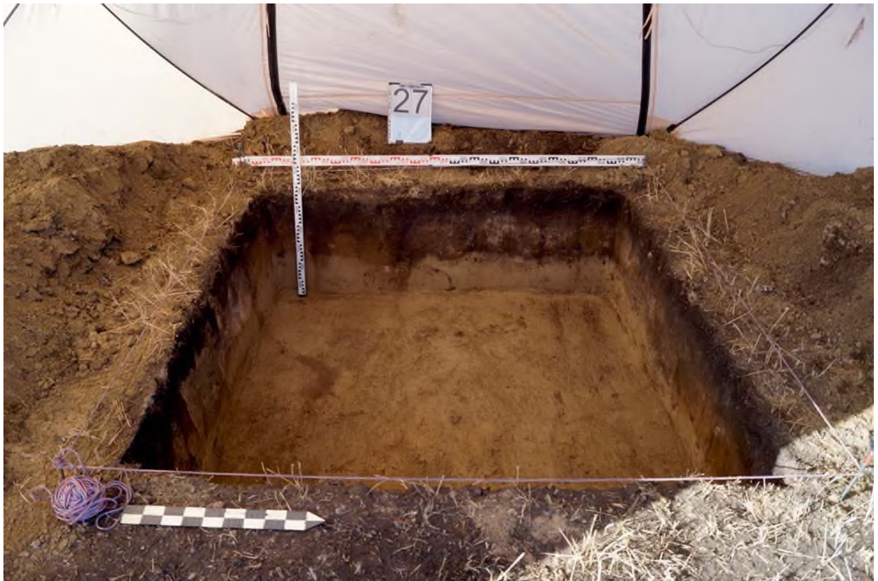
Иллюстрация № 206 (фото). Археологические полевые работы на территории земельного участка, предназначенного под объект: «Проект разработки Никольского каменноугольного месторождения с производственной мощностью 18 млн. тонн угля в год». Горные работы». Профиль западной стенки шурфа № 27. Вид с востока.
