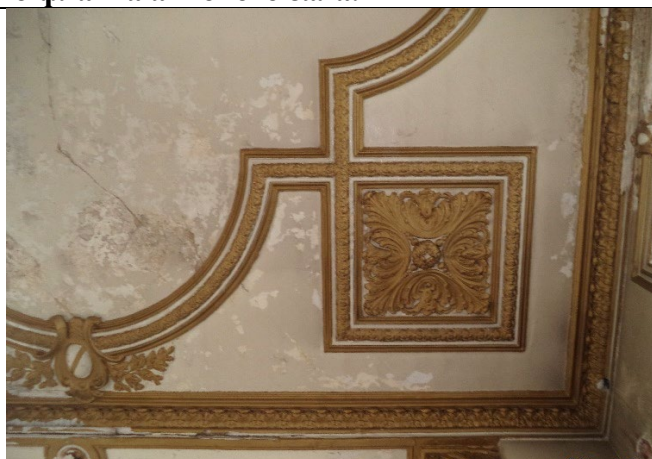
Угловая розетка актового зала
