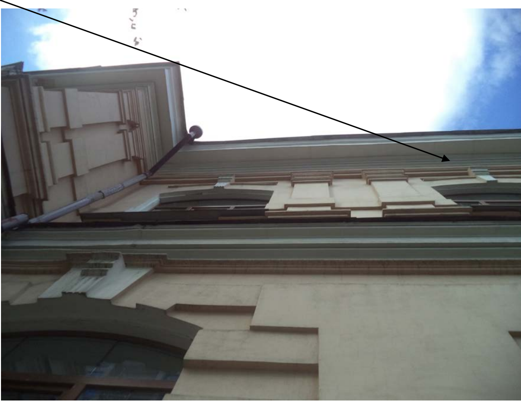
Фото 18. Главный фасад по ул. Чкалова. Левое крыло. Трещины на штукатурке поперек и вдоль карниза Риск постепенного и отслоения и падения фрагментов штукатурки на тротуар
