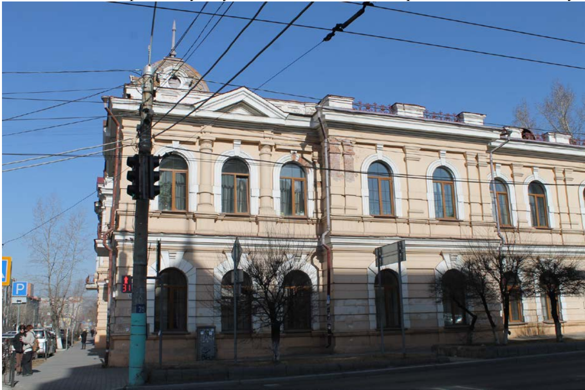
Фото 43. 44. Главный фасад по ул. Бутина. Общее состояние. Фрагменты отслоений штукатурки
