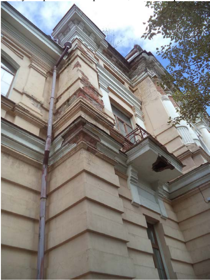
Фото 21.22 Главный фасад по ул. Чкалова. Центральный ризалит. Повсеместное отслоение и падение штукатурки фасадов с участков фриза, карниза, верхней части стен, пилястр ввиду неправильной организации или повреждения водостока с крыши
