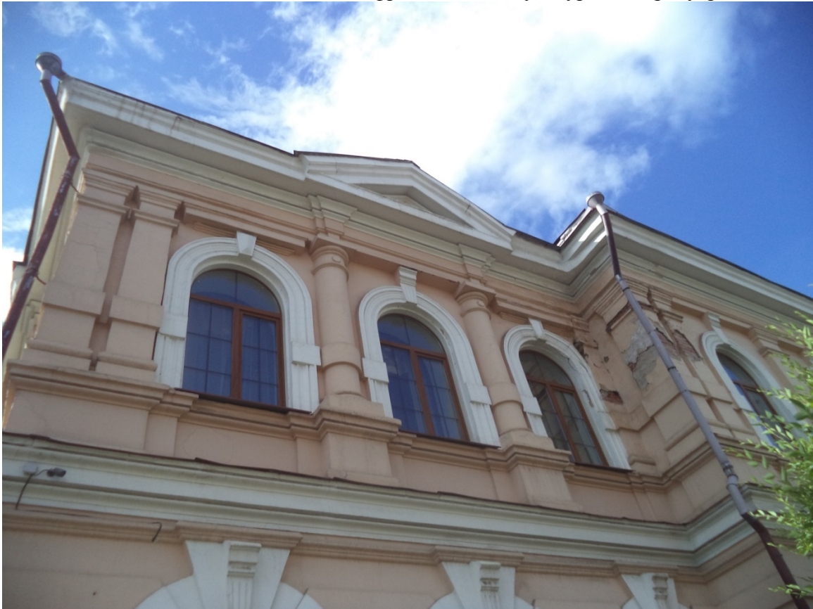
Фото 41. 42. Главный фасад по ул. Бутина. Трещины на штукатурке Риск отслоения и падения фрагментов штукатурки на тротуар
