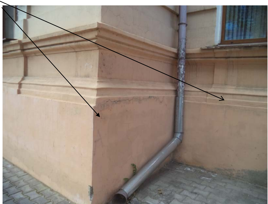
Фото 17. Главный фасад по ул. Чкалова. Левый ризалит. Цоколь. Трещины на штукатурке Потечи. Загрязнения
