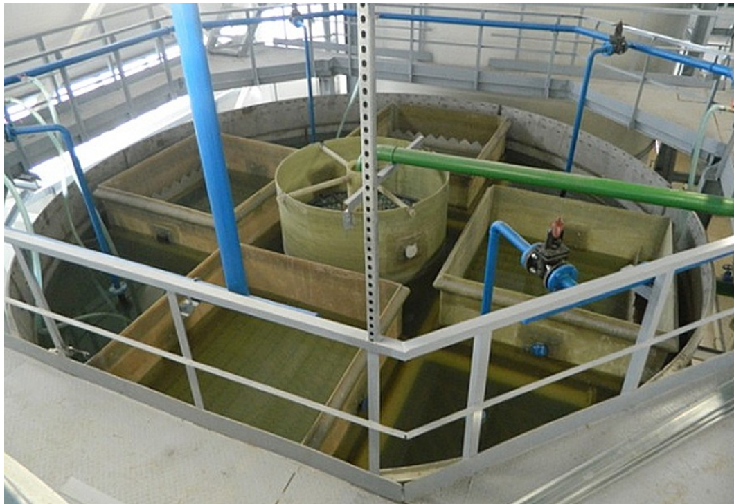
Рисунок 10 - Очистные сооружения серии «БИОТОК М»
