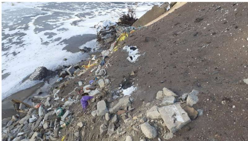
Рис 7. Выход дыма из-под насыпи. Координаты: 51.33868; 110.50774
