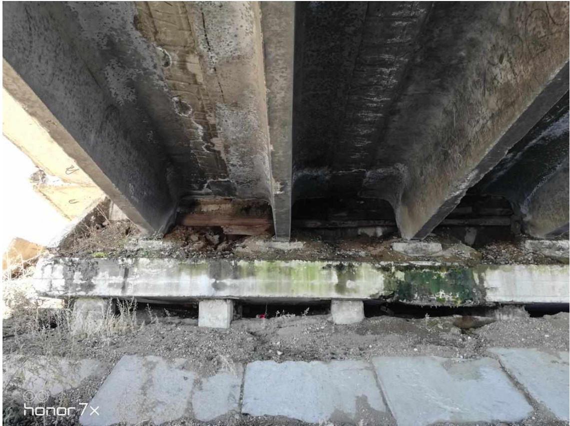
Фото 5. Начало моста, загрязнение опорных узлов.
