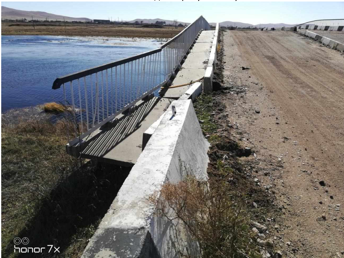
Фото 2. Начало моста. Разрушение тротуарной плиты с левой стороны моста.
