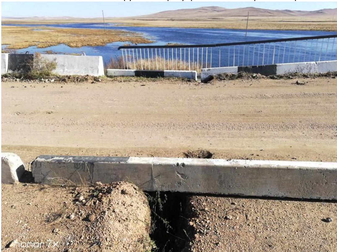
Фото 4. Наличие локальных разрушений слоев дорожной одежды вдоль деформационных швов ПК 3+57.87.
