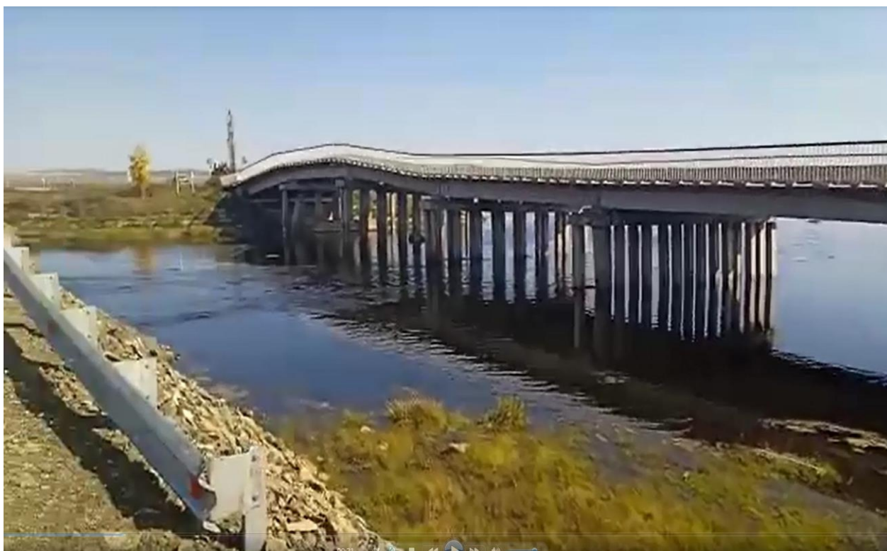
Вид на аварийный реконструируемый мостовой переход
